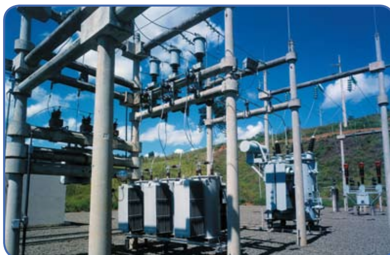
Banco de reguladores monofásicos em subestação de 10 MVA Banco de reguladores monofásicos em subestación de 10 MVA
